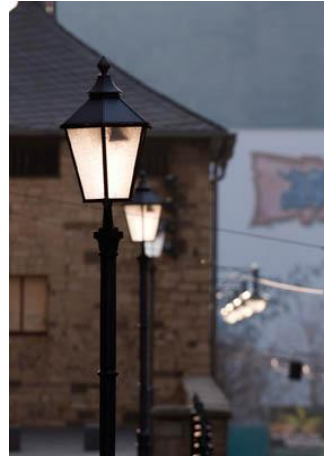
Abbildung 23: Straßenbeleuchtung in Halle 103
